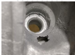
Corrosie achter het pluggat
